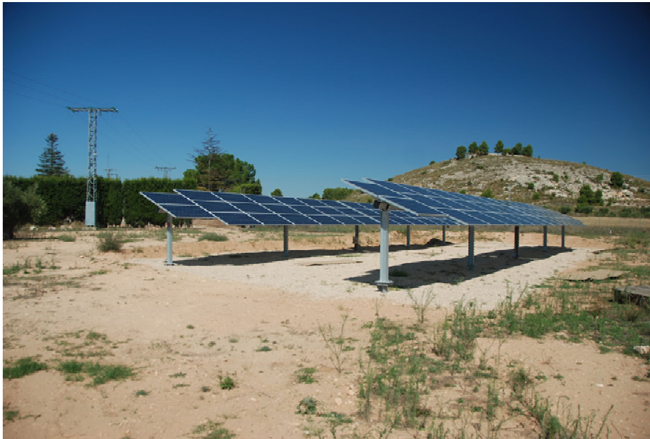
Figura 3. Generador fotovoltaico de una bomba fotovoltaica que bombea a costes más baratos que los actuales de la red.
